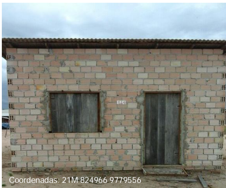
LEGENDA: Residência destruída na rua 02 s/n, bairro de Planalto
