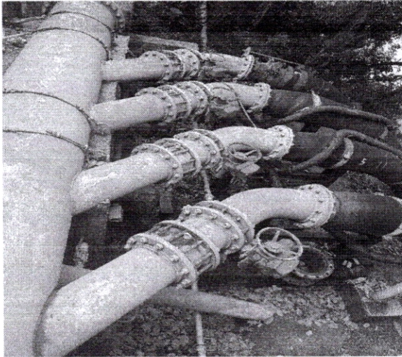
Figura 05: Alimentação da Adutora de Ø600 da Captação 01 – Carretel e Válvulas
