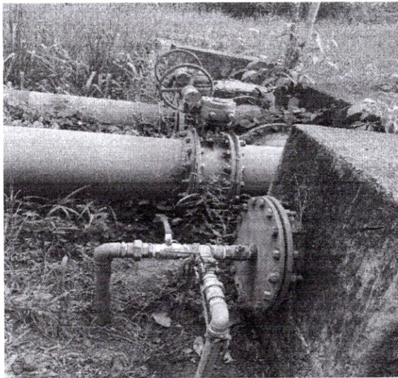
Figura 07: Flanges e Válvulas da saída da Captação 02 – Flanges e Válvulas
